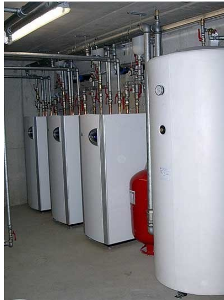
Figura 2: Uno dei tre locali tecnici; si possono vedere le pompe di calore e il buffer inerziale da 750l
